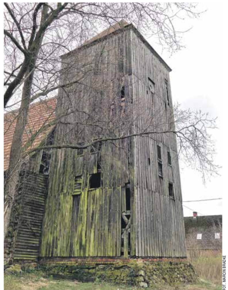
Wieża kościelna grozi zawaleniem
